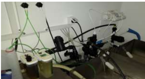
Srednje velika črpalna postaja z dvema posodama za gnojilo, filtrom za obratno osmozo za mehko vodo, dvema posodama za skladiščenje vode in dvema črpalkami
